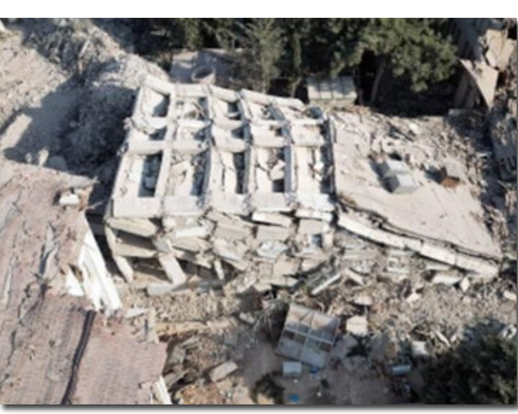
Fotoğraf 3: Betonarme bina toptan göçme (2)
